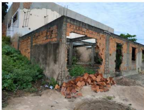
Imagem 01 – Vista externa, alvenaria deteriorada, armadura exposta e com corrosão avançada
