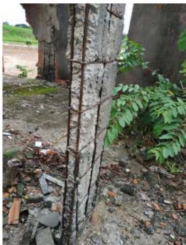
Imagem 09 – Vista interna, armadura exposta com corrosão avançada, concreto com porosidade elevada
