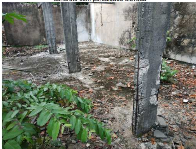
Imagem 08 – Vista interna, armadura exposta com corrosão avançada, concreto com porosidade elevada
