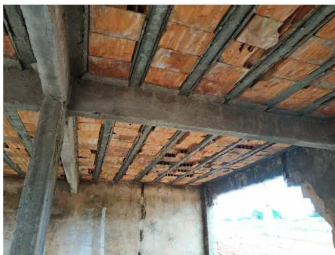
Imagem 07 – Vista interna, armadura exposta com corrosão avançada, concreto com porosidade elevada
