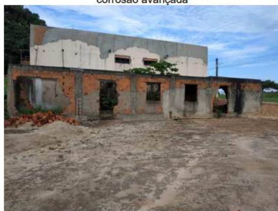
Imagem 02 – Vista externa, alvenaria deteriorada, armadura exposta e com corrosão avançada Engº Exuperio Alves de Queiroz
