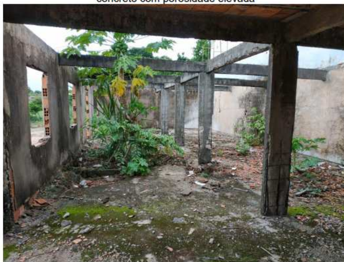
Imagem 06 – Vista interna, armadura exposta com corrosão avançada.
