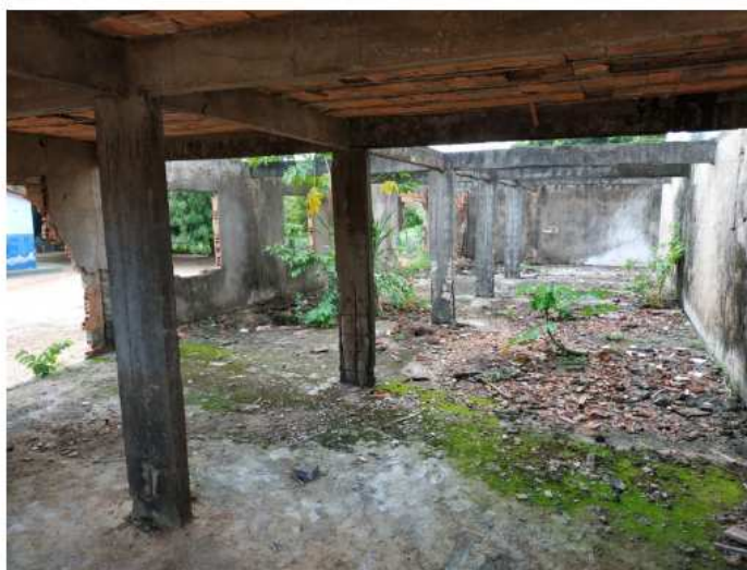
Imagem 05 – Vista interna, armadura exposta com corrosão avançada, concreto com porosidade elevada
