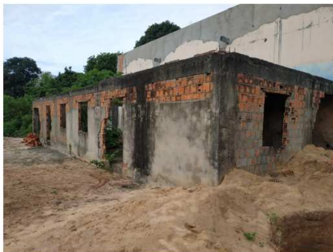
Imagem 03 – Vista externa, alvenaria deteriorada, armadura exposta e com corrosão avançada
