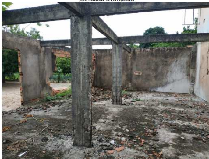
Imagem 04 – Vista interna, armadura exposta com corrosão avançada, concreto com porosidade elevada
